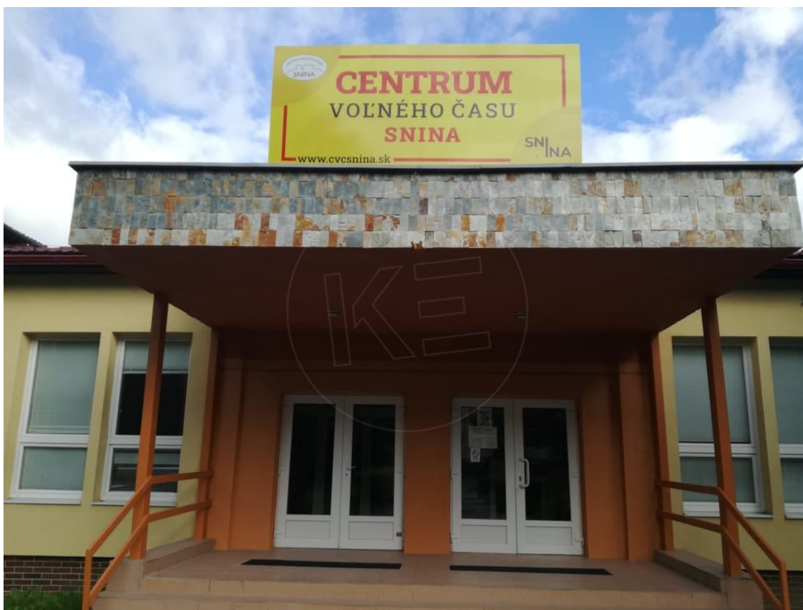
Strecha budovy je v havarijnom stave / facebook.com/cvcnsina/
